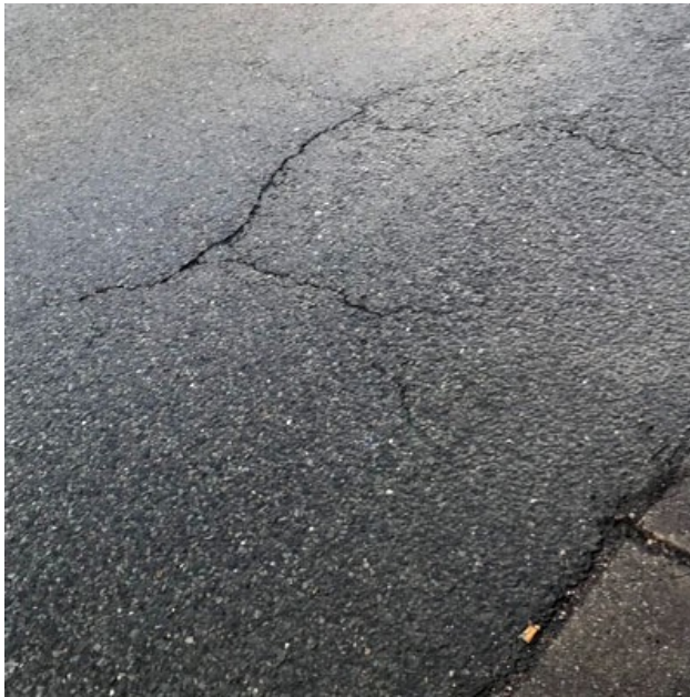
Ex: fissure transverse sur une route
